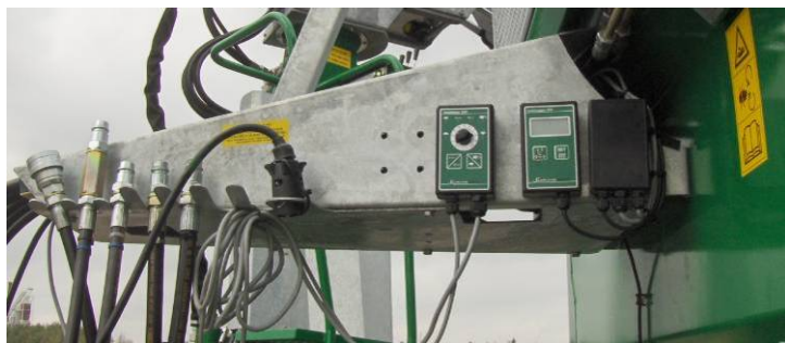
Obrázek elektrického panelu v přední části rozmetadla
