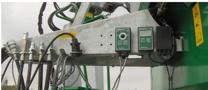
Obrázek elektrického panelu v přední části rozmetadla
