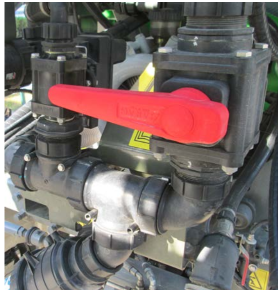
Obrázek 6.33. ventilu proti znečištění uzavřený
